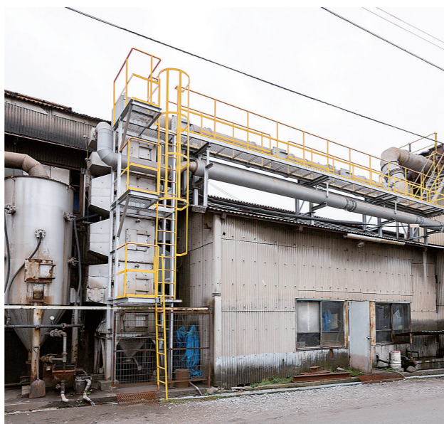
本事業により導入した熱交換器設備で、1,500℃ほどの高温に変換。コークスの品質や材料費の高騰にも左右されることなく生産性が向上。
