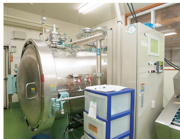
最新型の高温高圧殺菌装置を導入、品質と生産性が向上した。
