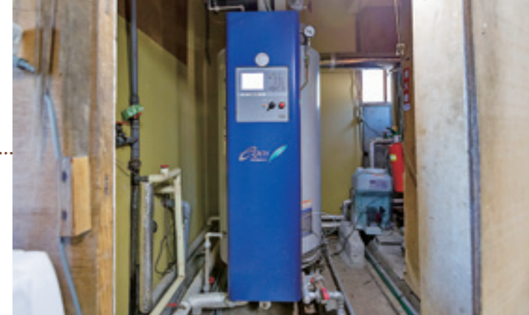
本事業により導入した「貫流式蒸気ボイラー」。酒づくりでは「蒸し米・麴づくり」と「火入れ・瓶詰め」の際に重要な役割を果たす。
