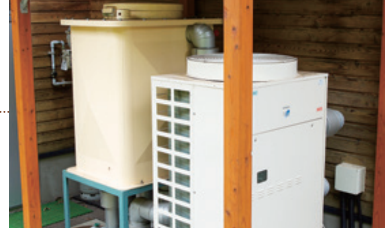
工場の脇に設置された酒石落とし用冷却整備機器。適温に設定した不凍液をワインタンク回りに循環させ、発酵に最適な環境をつくりだす。
